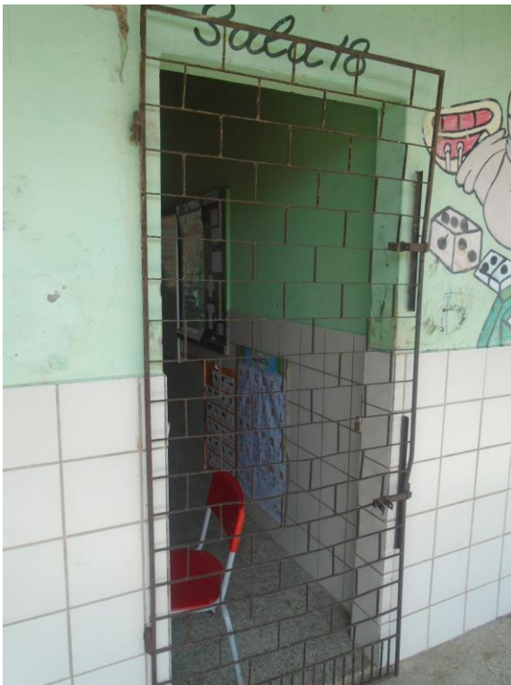
Imagem 19 – Foto tirada in loco da sala com grade enferrujada e amassada. Fonte: COPROJ-SEINF
