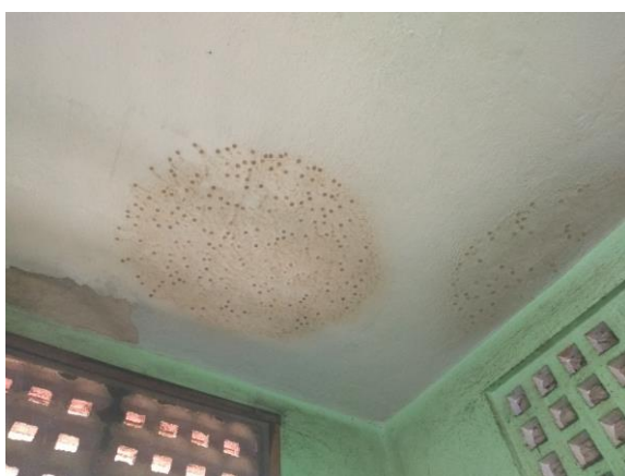
Imagem 08 – Foto tirada in loco da laje da cozinha. Fonte: COPROJ-SEINF.
