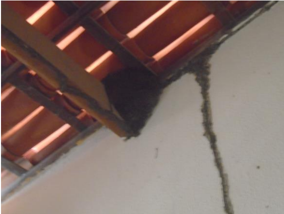
Imagem 10 – Foto tirada in loco do banheiro com cupinzeiro. Fonte: COPROJ-SEINF.
