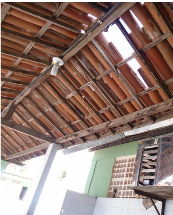
Imagem 12 – Foto tirada in loco da coberta do corredor que dá acesso às salas. Fonte: COPROJ-SEINF.
