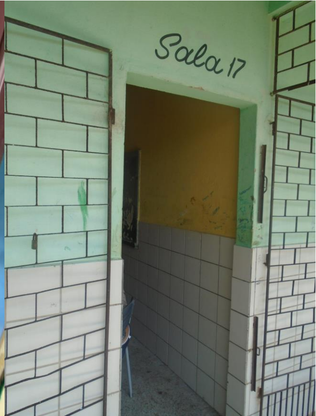
Imagem 19 – Foto tirada in loco da sala sem porta. Fonte: COPROJ-SEINF
