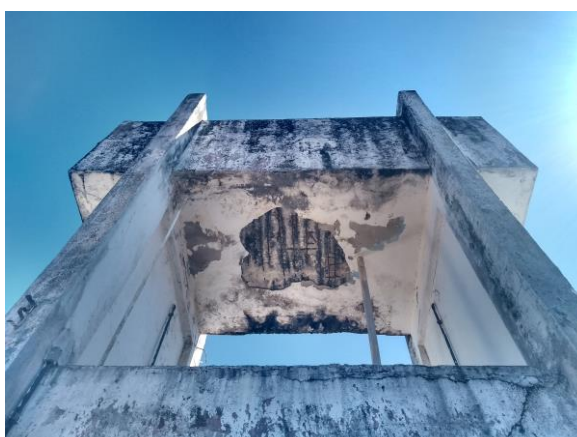
Imagem 09 – Foto tirada in loco da estrutura da caixa d'água. Fonte: COPROJ-SEINF.
