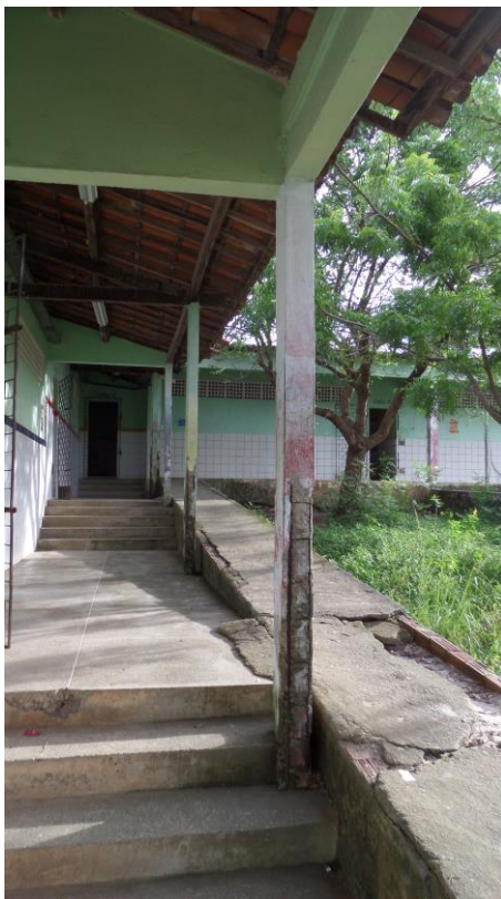
Imagem 04 – Foto tirada in loco da rampa de acesso às salas. Fonte: COPROJ-SEINF.
